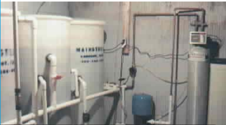
Le système de traitement des eaux souterraines comporte plusieurs barrières :
