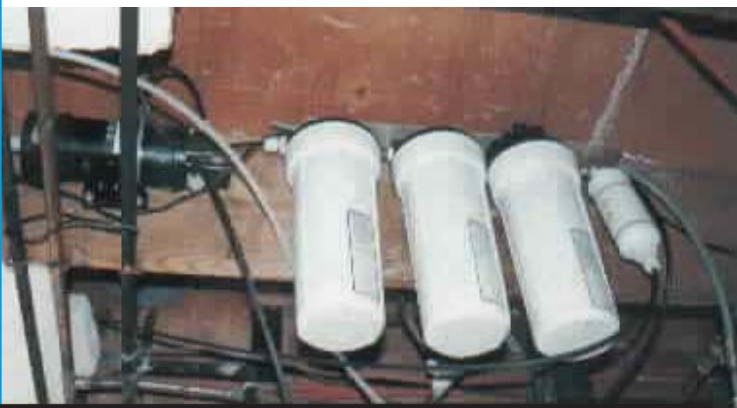
Le dispositif complémentaire à osmose inverse comprend :
