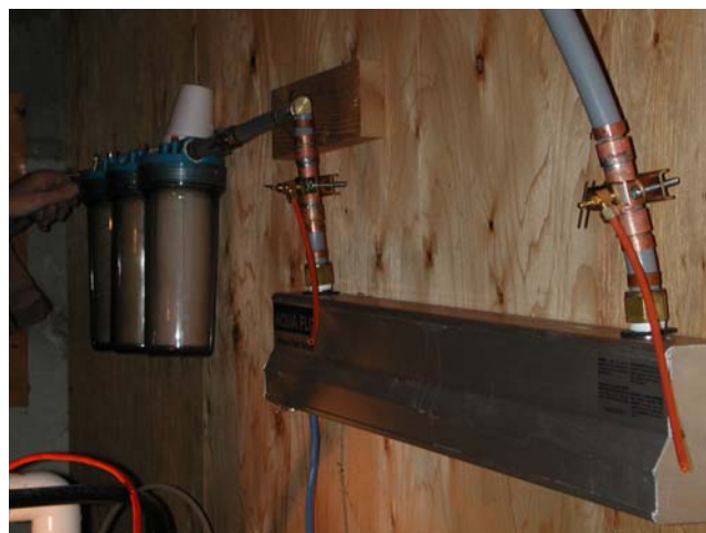
Figure 9: Appareil de traitement UV et préfiltre à cartouche solidement fixés au mur
