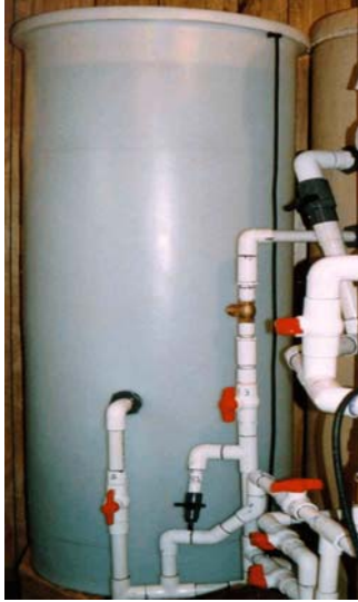
Figure 5 - Réservoir d'eau domestique - stockage de l'eau pendant deux jours
