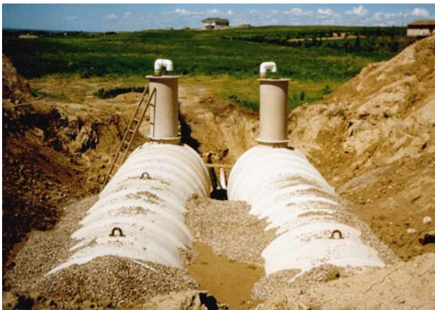
Figure 6 - Citernes: réservoirs de stockage d'un grand volume d'eau
