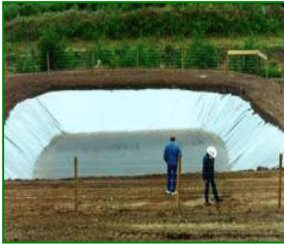
Réservoir de stockage en terre surélevé avec revêtement de polyéthylène tissé
